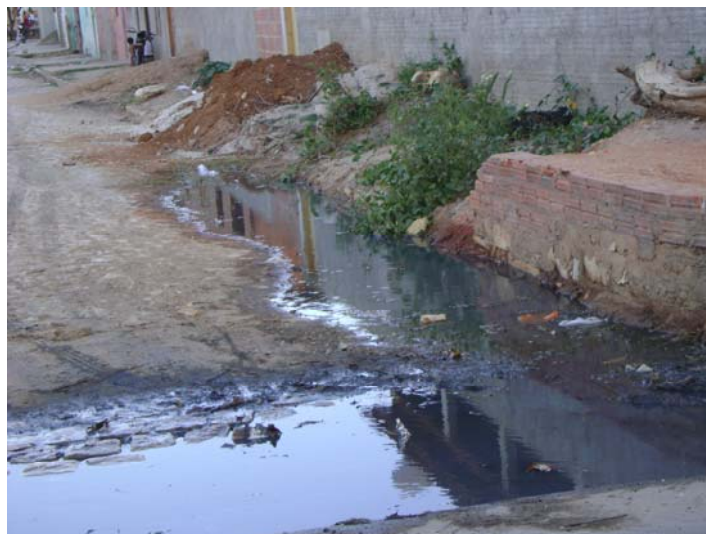
Figura 49 - Esgoto a céu aberto observado em rua do Bairro Abolição.
