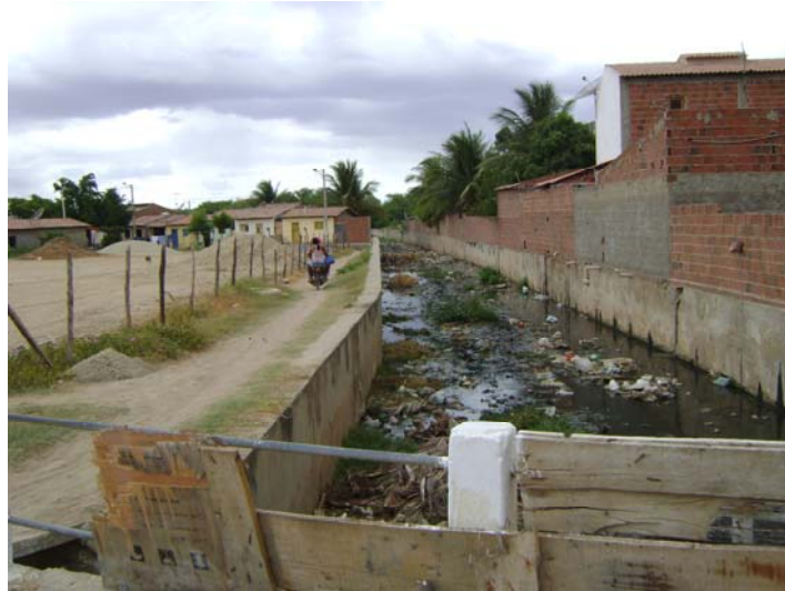
Figura 50 - Situação de esgotamento sanitário verificada no Bairro Alto de São Manoel.
