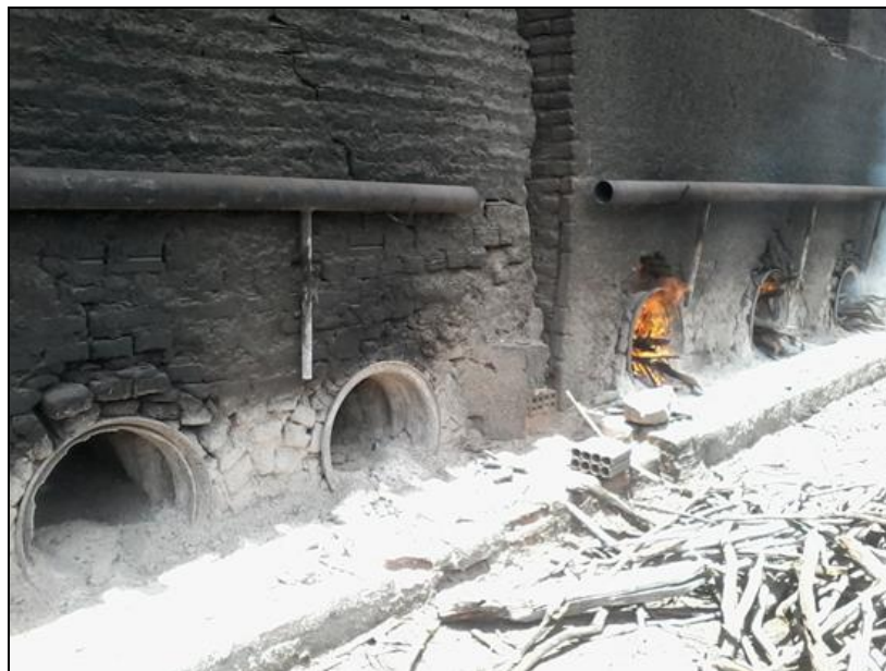
Figura 19 – Vista parcial dos fornos de uma Indústria ceramista de Carnaúba dos Dantas-RN. 2013.
