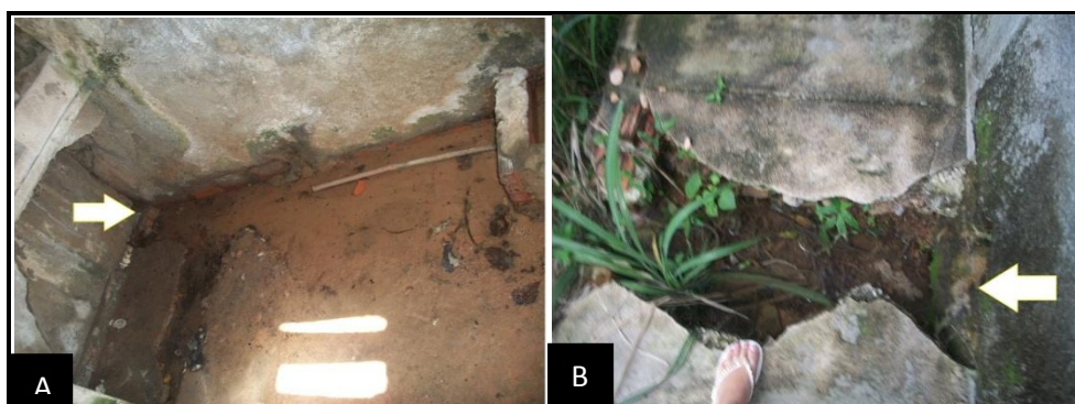
FIGURA 65- A) Abertura feita para a percolação da água no interior da lavanderia para a vertente da serra (área interna). B) Abertura feita para a percolação da água no interior da lavanderia para a vertente da serra (área externa)
