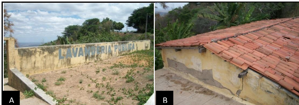
FIGURA 61- A) e B) Lavanderia pública desativada com a nascente no seu interior
