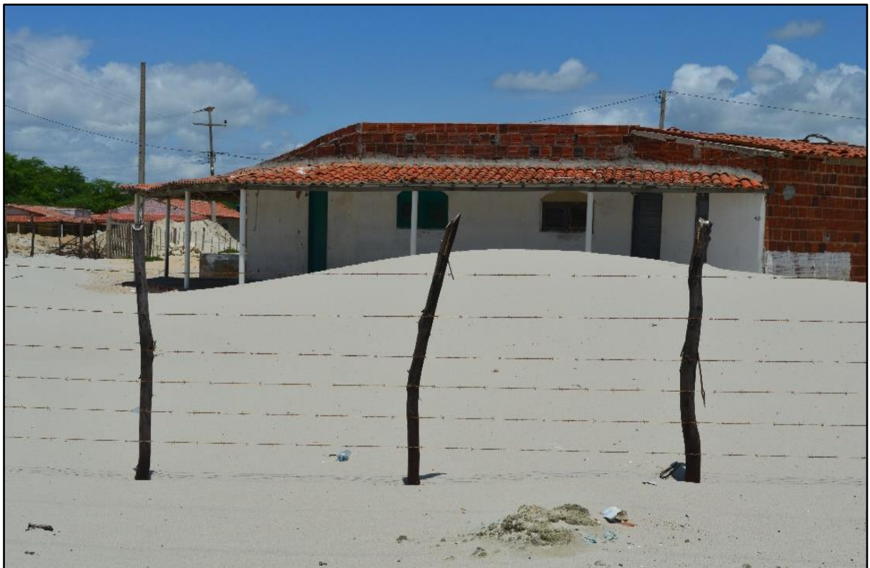
Figura 5 – Soterramento de casas através do fluxo de sedimento em comunidades de Grossos.
