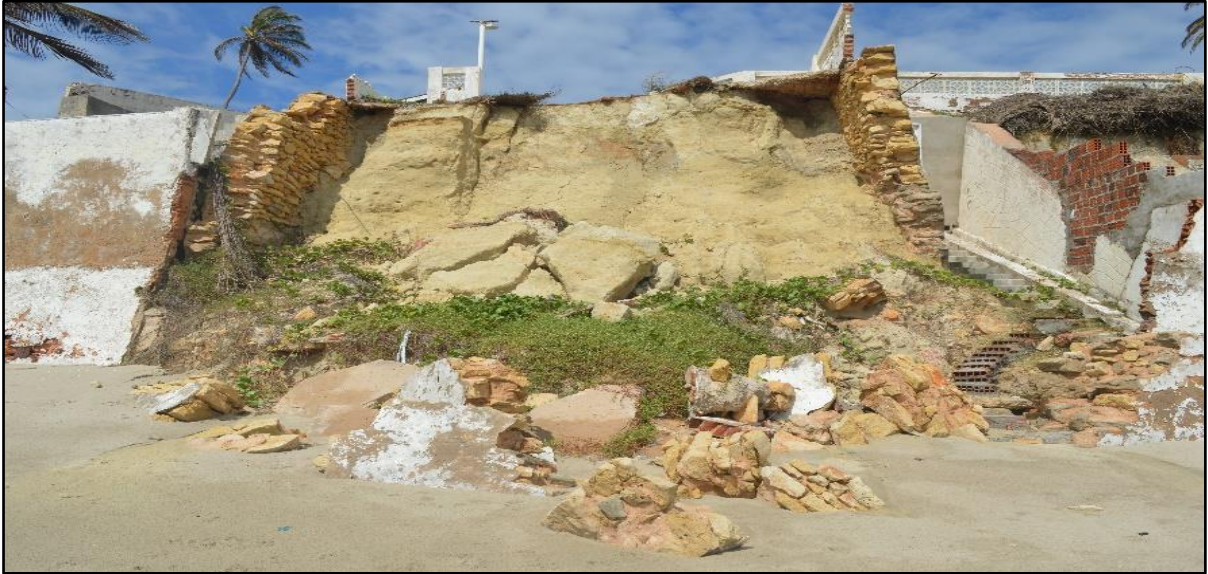
Figura 24 – Muro de casa de veraneio derrubado pela força das ondas na orla marítima de Tibau (RN).
